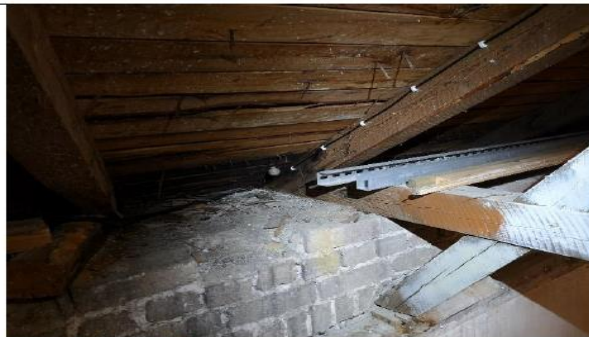
Kuva 3. Rakennuksen vesikatolla on havaittavissa lumen sulamista. Sulaminen on seurausta tuulettuvan ullakkotilan korkeasta lämpötilasta. Vesikatteena on peltikate, jonka saumojen kautta sulanut/ paineellinen vesi voi päästä ja kastella alempia rakenteita. Suositellaan lumen pudottamista vesivuotoriskien välttämiseksi. (2/2)
