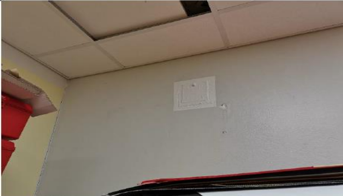
Kuva 4. Kohteessa on vanhoja painovoimaisen ilmanvaihdon aikaisia alkuperäisiä rakennusaineisia korvausilmaventtiilejä sekä poistohormoja, jotka on tulpattu, koska kohteessa on nyt käytössä koneellinen tulo-poistoilmanvaihto. Suositellaan alkuperäisten poistohormien tulppausten tarkastamista, jotta varmistutaan siitä, että niiden kautta ei kulje ilmaa sisätiloihin.
