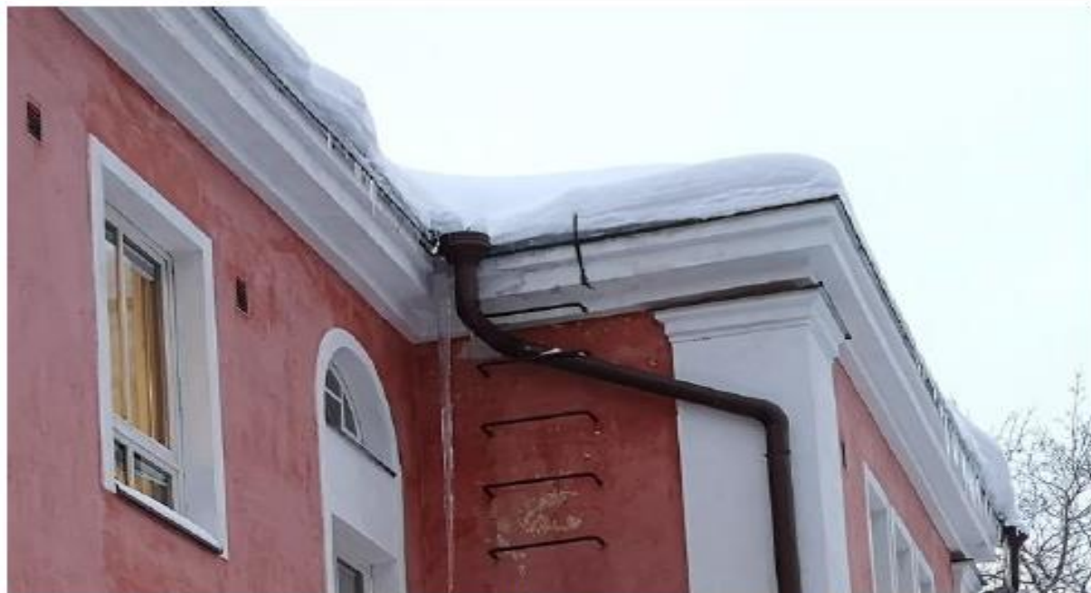
Kuva 2. Rakennuksen vesikatolla on havaittavissa lumen sulamista. Sulaminen on seurausta tuulettuvan ullakkotilan korkeasta lämpötilasta. Vesikatteena on peltikate, jonka saumojen kautta sulanut/ paineellinen vesi voi päästä ja kastella alempia rakenteita. Suositellaan lumen pudottamista vesivuotoriskien välttämiseksi. (1/2)
