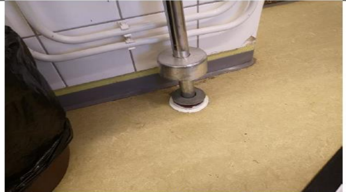
Kuva 5. Kohteessa on vastikään tiivistettyjä talotekniikan läpivientejä mm. lattiarakenteissa. Suositellaan läpivientien tarkastamista laajemmin, että läpiviennit on tiivistetty asianmukaisesti.
