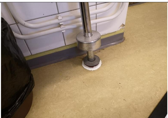
Kuva 5. Kohteessa on vastikään tiivistettyjä talotekniikan läpivientejä mm. lattiarakenteissa. Suositellaan läpivientien tarkastamista laajemmin, että läpiviennit on tiivistetty asianmukaisesti.
