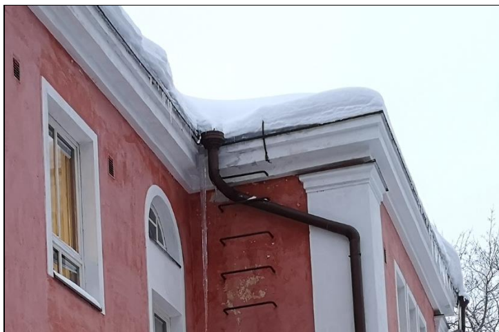
Kuva 2. Rakennuksen vesikatolla on havaittavissa lumen sulamista. Sulaminen on seurausta tuulettuvan ullakkotilan korkeasta lämpötilasta. Vesikatteena on peltikate, jonka saumojen kautta sulanut/ paineellinen vesi voi päästä ja kastella alempia rakenteita. Suositellaan lumen pudottamista vesivuotoriskien välttämiseksi. (1/2)
