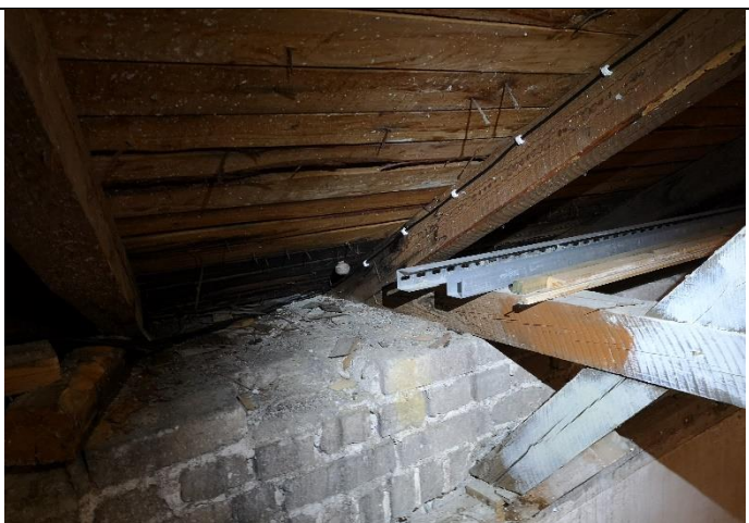
Kuva 3. Rakennuksen vesikatolla on havaittavissa lumen sulamista. Sulaminen on seurausta tuulettuvan ullakkotilan korkeasta lämpötilasta. Vesikatteena on peltikate, jonka saumojen kautta sulanut/ paineellinen vesi voi päästä ja kastella alempia rakenteita. Suositellaan lumen pudottamista vesivuotoriskien välttämiseksi. (2/2)
