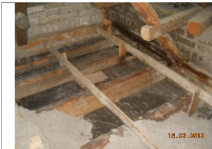
Kuva 6. Kattovesivuoto 2013. Raportin /12./ mukaan kastuneet materiaalit poistettiin tai kuivattiin.
