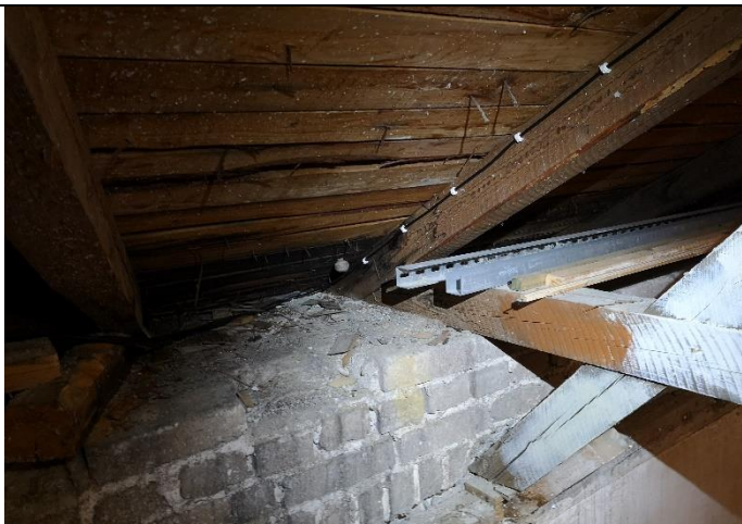
Kuva 5. Rakennuksen vesikatolla oli katselmuksessa havaittavissa lumen sulamista. Sulaminen on seurausta tuulettuvan ullakkotilan korkeasta lämpötilasta. Vesikatteena on peltikate, jonka saumojen kautta sulanut/ paineellinen vesi voi päästä ja kastella alempia rakenteita. (2/2)
