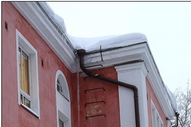
Kuva 4. Rakennuksen vesikatolla oli katselmuksessa havaittavissa lumen sulamista. Sulaminen on seurausta tuulettuvan ullakkotilan korkeasta lämpötilasta. Vesikatteena on peltikate, jonka saumojen kautta sulanut/ paineellinen vesi voi päästä ja kastella alempia rakenteita. (1/2)
