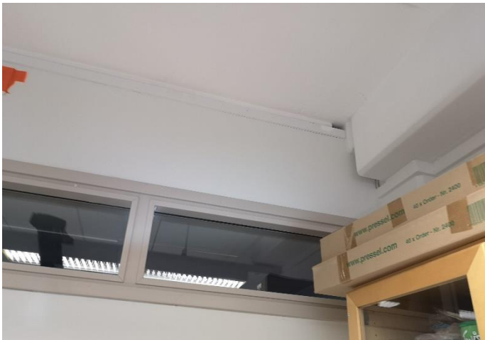
Kuva 7. Laajennusosa huone 231 väliseinän reiän kautta tulee ilmavirtausta, koska tuloilmakanava vuotaa väliseinän sisään.
