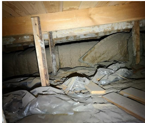
Kuva 12. Vanhan peruskorjatun osan yläpohjarakenteen tuuletustila vesikaton alapuolella. Lämmöneristekerroksessa on sinne kuulumattomia rakennustarvikkeita, kuten muoveja, bitumikerman palasia, sahatavaran kappaleita.
