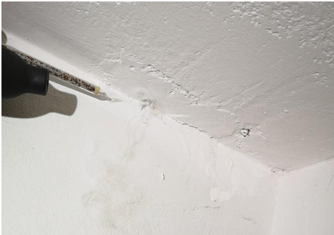
Kuva 5. Rakenteiden ilmanpitävyyden selvittäminen merkkisavulla. Laajennusosa huone 231 yläpohjan ilmavuotokohta.
