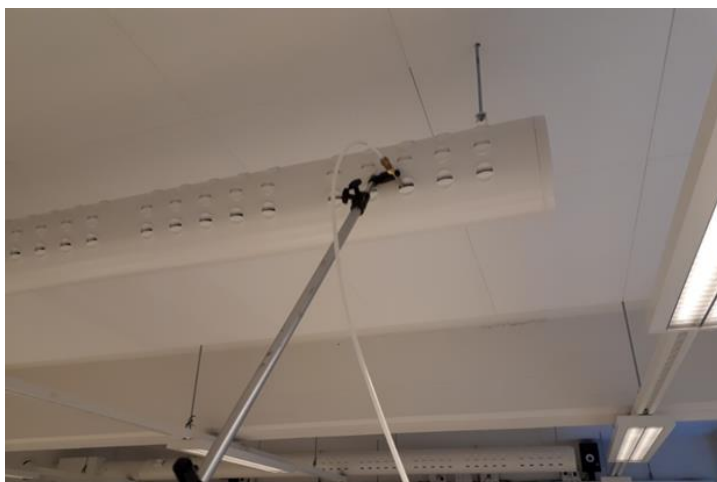
Kuva 20. Tuloilmamittaus: huone 161, luokkatila.
