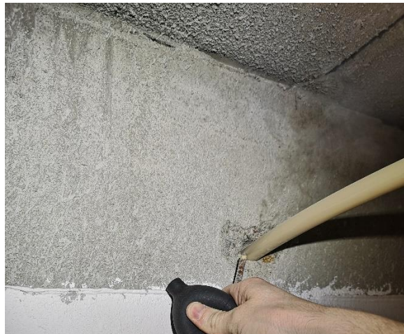
Kuva 8. Laajennusosa huone 210. Ulkoseinän sähköläpiviennin ilmavuoto ulkoseinässä.
