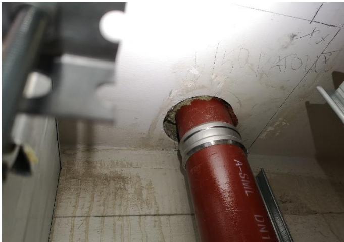
Kuva 11. Puutteellinen läpivienti luokan 161 yläpuolella 2. krs olevassa käytävässä. Myös muissa samalla väliseinälinjalla olevissa läpivienneissä on tiiviyspuutteita.
