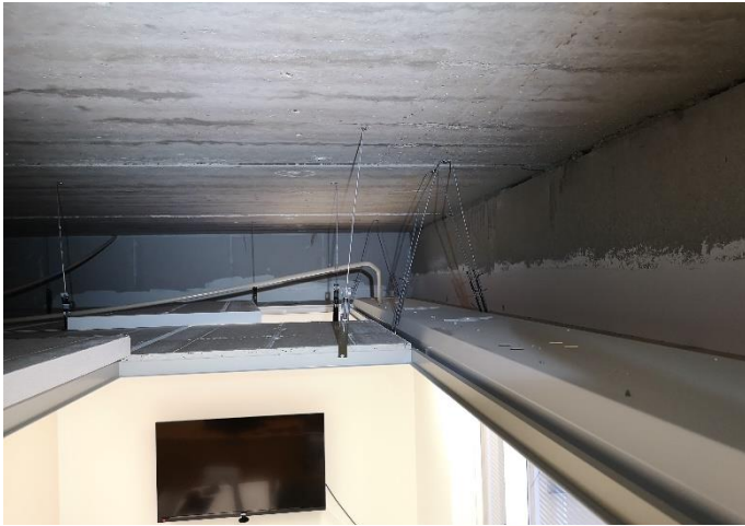
Kuva 9. Laajennusosa huone 210. Paikallisia ilmavuotokohtia ulkoseinän ja yläpohjan liitoksessa.
