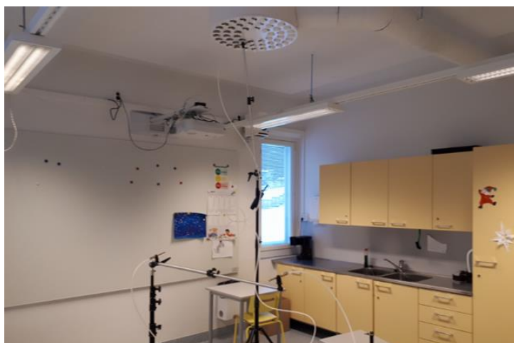
Kuva 21. Sisä- ja tuloilmamittaus: Huone 184b, ryhmätila.
