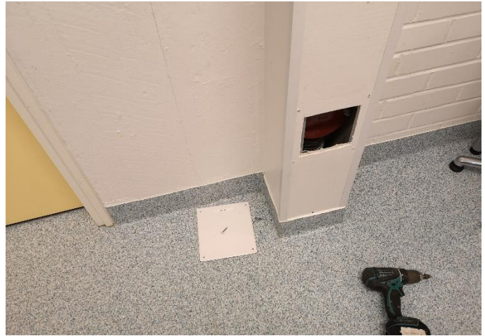
Kuva 10. Viemärin hormi luokkatilassa 161 (peruskorjattu osa 1. krs). Hormin kautta tulee ilmaa luokkatilaan ylhäältä hormista. Ilman virtaus viittaa yläpohjan läpiviennin puutteelliseen ilmatiiviyteen. Kuvassa puhdistusluukun peitelevy on poistettu.
