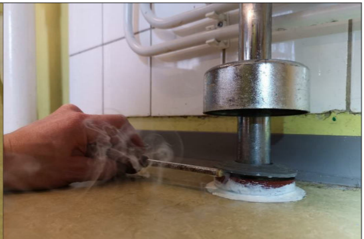
Kuva 17. Kalusteviemärien liitoksessa lattian viemäriputkeen havaittiin pientä ilmavuotoa viemäristä sisäilmaan, kun luokkatila oli alipaineinen (-5...-10 Pa) suhteessa ulkoilmaan.
