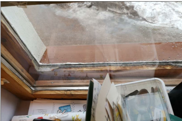
Kuva 22. Ikkunat ovat kunnostuksen tarpeessa etenkin ulkopuitteen osalta. Kunnostustarve oli suurinta eteläjulkisivulla sekä länsijulkisivulla.
