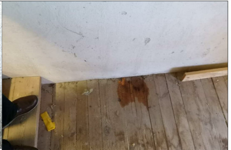
Kuva 27. Paikallisen vesivuotokohdan kautta on päässyt tippumaan vettä yläpohjan puurakenteisen porraskäytävään.
