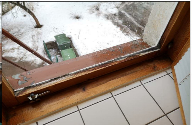
Kuva 23. Ikkunat ovat kunnostuksen tarpeessa etenkin ulkopuitteen osalta. Eniten kunnostusta kaipaavissa ikkunoissa tarkastushetken sateisella säällä ulkopuite oli märkänä sisäpuolelta.
