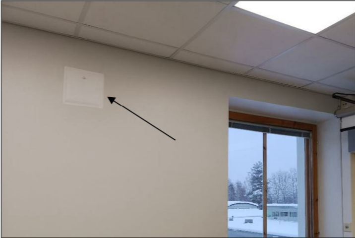
Kuva 20. Painovoimaisen ilmanvaihdon alkuperäisissä kiviainesrakenteisissa ilmanvaihtoreiteissä ei havaittu ilmavuotokohtia. Ne oli ummistettu vuonna 2018 tehdyssä korjauksessa.
