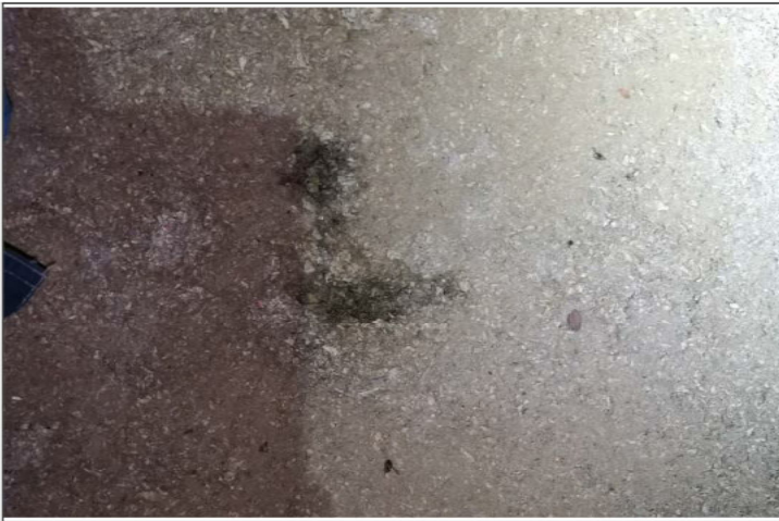
Kuva 26. Paikallisen vesivuotokohdan kautta on päässyt tippumaan vettä yläpohjan selluvillalämmöneristeeseen.
