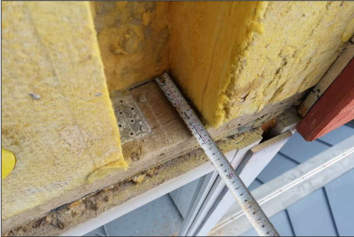
Kuva 5. RA1. Lämmöneristekerroksen paksuus 12-13 cm ja pesubetonisen ulkokuoren 6-7 cm. Lämmöneristyskerroksessa ei havaittu poikkeavia hajuja tai kosteuden aiheuttamia jälkiä.
