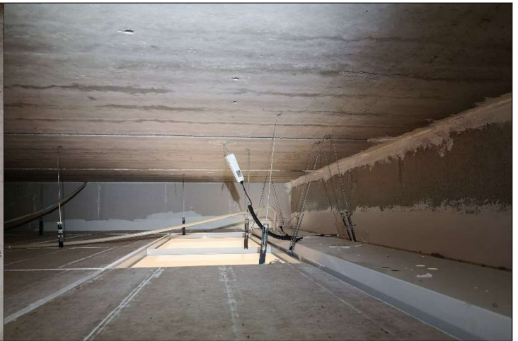
Kuva 12. Yläpohjan ontelolaatan ontelotilan ilman kosteusmittaus huoneessa 210. Mittauksen perusteella ontelotilan ilman lämpötila vaihteli välillä 17,6-21,1 C ja suhteellinen kosteus 36-45 RH-%. Sisäilman lämpötila ja suhteellinen kosteus yhdestä mittapisteestä mitattuna alakaton päältä olivat 20,3 C ja 45 RH-%. Tulosten perusteella ontelot ovat kuivia (tasapainokosteudessa sisäilman kanssa eli onteloissa ei ollut mittaushetkellä yhtään enempää kosteutta kuin sisäilmassa).
