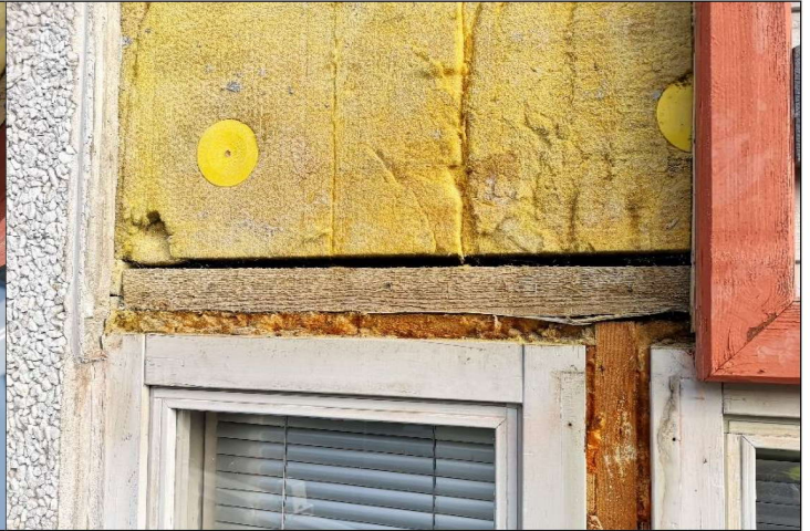
Kuva 6. RA1. Puujulkisivun ja ikkunan yläreunan apukarmin kohdalla lämmöneristekerros ei ole tiiviisti runkokuuta vasten vaan kohdassa on selkeä rako. Tämä heikentää ulkoseinän lämmöneristävyttä.
