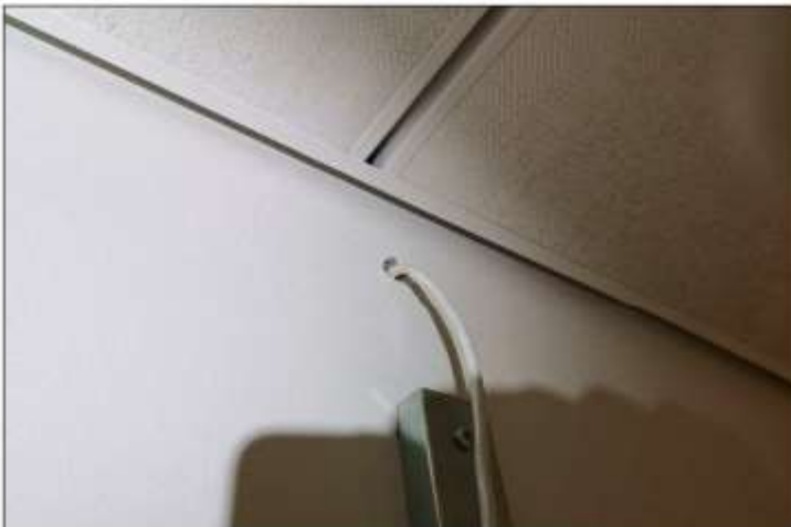
Kuva 20. Luokassa 234 havaittiin ulkoseinän sähköläpivientejä, joissa tapahtui selkeää ilmanvirtausta. Läpivientien kautta sisäilmaan tuleva ilma voi sisältää epäpuhtauksia, joten suositellaan tiivistämään ulkoseinän läpi menevät läpiviennit.
