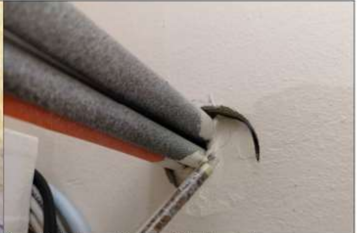
Kuva 19. Luokassa 234 havaittiin ulkoseinän sähköläpivientejä, joissa tapahtui selkeää ilmanvirtausta. Läpivientien kautta sisäilmaan tuleva ilma voi sisältää epäpuhtauksia, joten suositellaan tiivistämään ulkoseinän läpi menevät läpiviennit.
