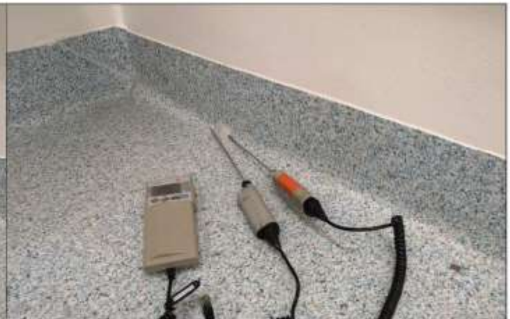
Kuva 11. Mittaus V3 tehtiin seinän ja lattian liitoksesta. Kosteus 31 RH-% oli sama kuin sisäilmassa, joten alhaista kosteuskokemaa selittää se, että kosteus pääsee tasaantumaan muovimaton seinälle noston takaa sisäilman olosuhteeseen.
