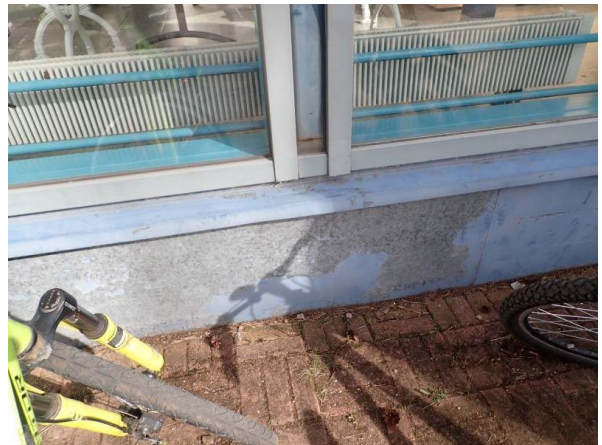
30. Laajennusosan sokkelipinnoilta irttaa maalipintaa
