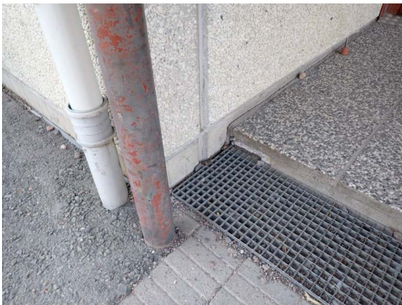
22. Katoksen metalliosat kaipaavat huoltomaalaamista
