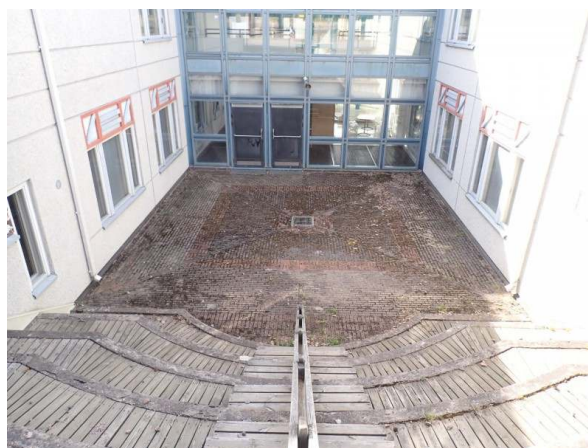
13. Sisäpihalla olevia betonikivetyksiä tulisi puhdistaa
