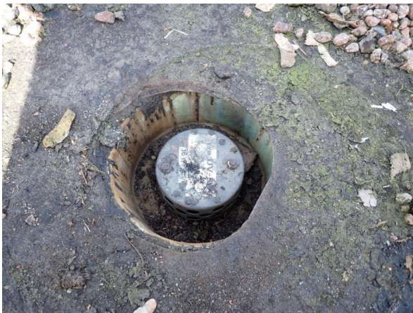
8. Kattokaivon ja katteen liitoskohta ei ole riittävän tiivis
