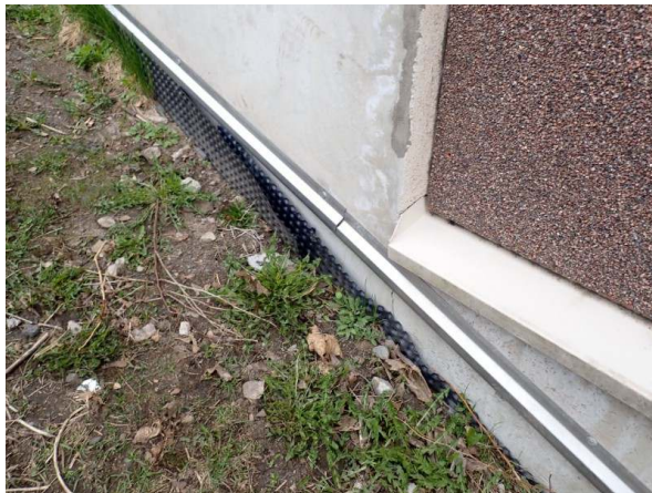
29. Vedeneristyslevyn yläreunasta puuttuu kiinnityslista
