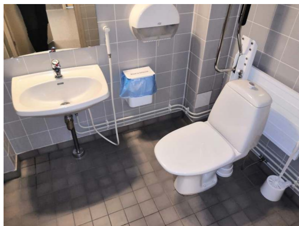
96. Vesi- ja viemärikalusteita laajennusosassa (osin vanhoja kalusteita).
