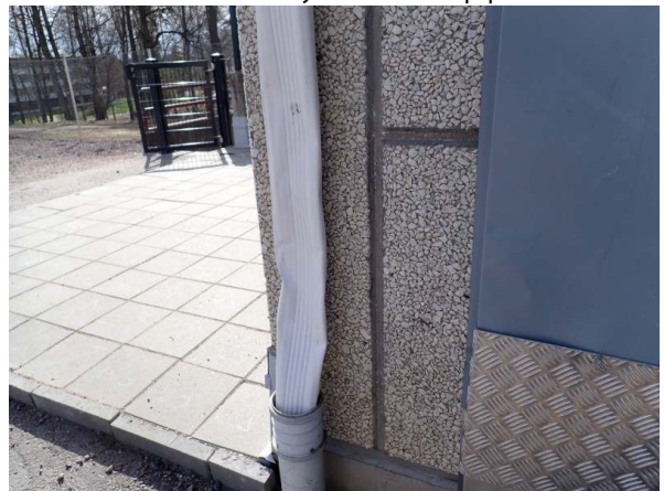
9. Syöksytorvi on rutussa
