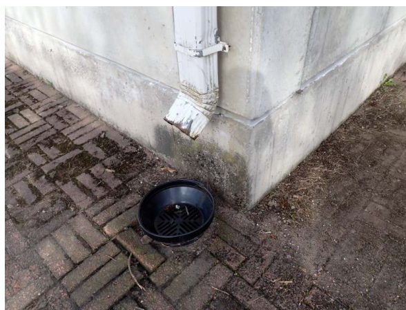
11. Sadevesiä on hieman roiskunut sokkelipinnoille.
