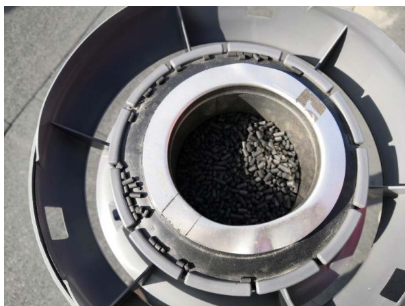
1. Tuuletusviemärin päässä on aktiivihiilirakeita.
