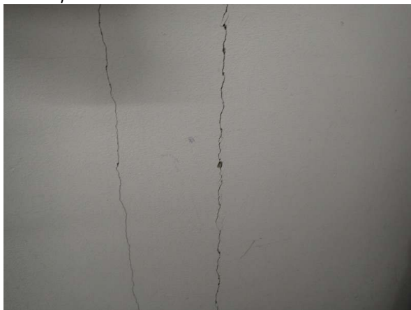
81. Pieniä halkeamia seinässä
