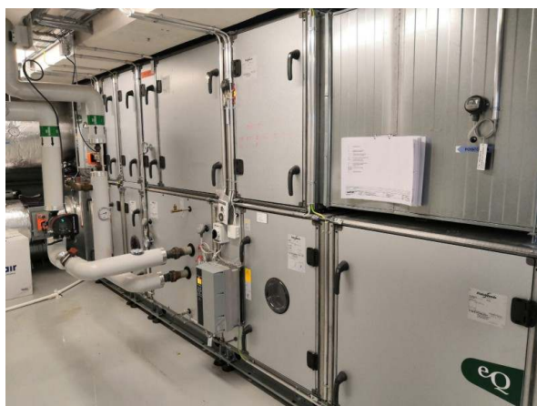
97. Ilmanvaihtokone TK1 on vuodelta 2014.
