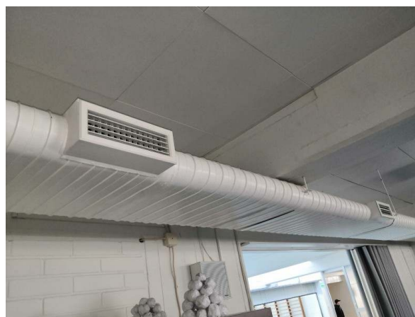
104. Ilmanvaihtokanavaa (keittiön/ruokalan yhteydessä).
