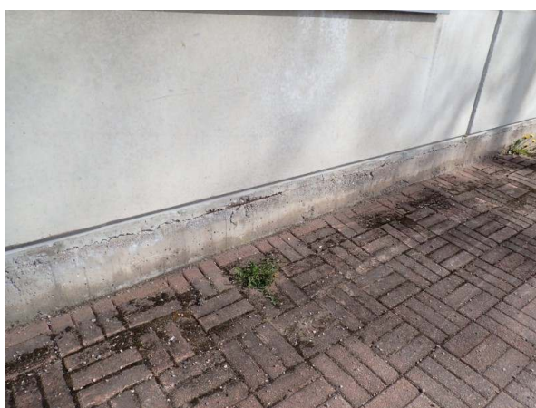
27. Sokkelin pinnoilla olevia vaurioita (laajennusosa)
