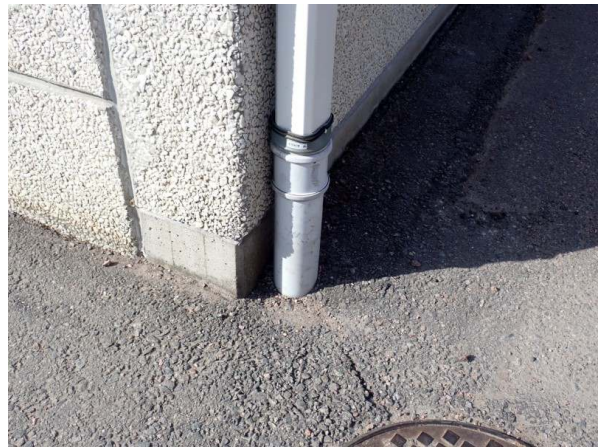
7. Osa sadevesistä on johdettu umpiputkiin
