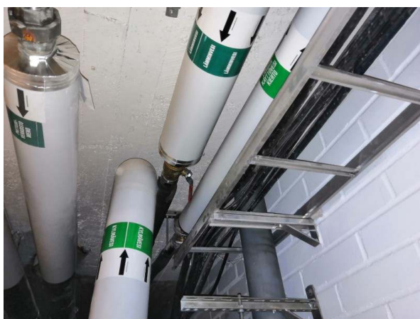
91. Vesijohtoja (lämmönjakokeskuksesta lähteviä).
