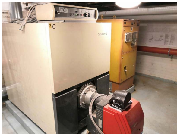
86. Käytöstä poistettu öljylämmityskattila.
