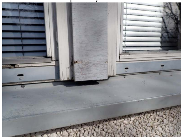
52. Peitelautoissa on maalipintojen kulumaa
