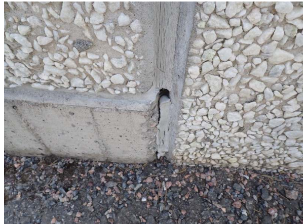
42. Saumoissa olevia reikiä tulisi paikkakorjata
