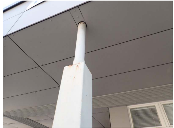
21. Katoksen maalipinnoilla on paikoin kulumaa ja ruostetta
