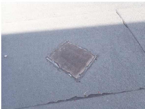
65. Vesikattoa on paikkakorjattu.
