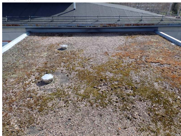
70. Rakennuksien välissä olevien portaikkojen katoilla on singelkerros, joka tulisi poistaa
