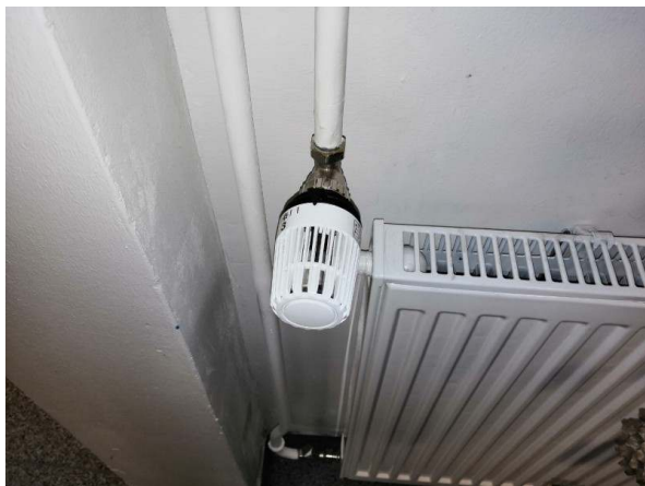
88. Termostaattinen patteriventtiili (vanha puoli).
