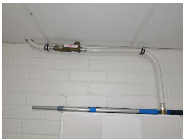
92. Vesijohdot ovat vanhalla osalla komposiittia ainakin kytkennöissä.
