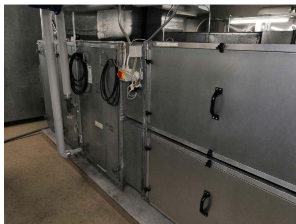
98. Ilmanvaihtokone 204 on vanhempi.
