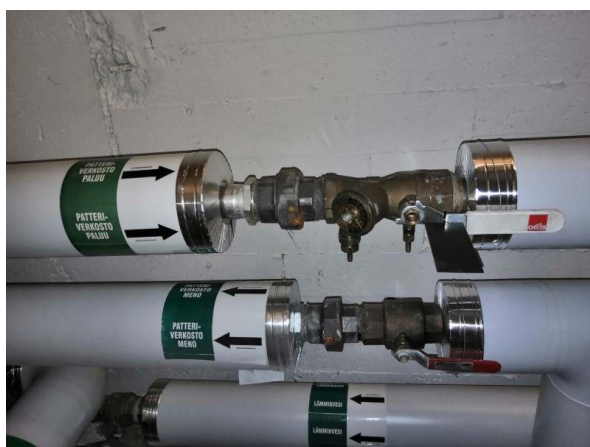
87. Linjasäätö- ja sulkuventtiilipari.
