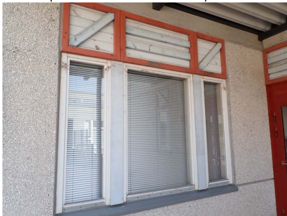
47. Ikkunoiden puitteissa ja peitelautoissa on paikoin maalipintojen kulumaa
