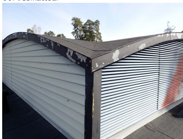
68. Katteen reunapelleissä on maalipintojen kulumaa
