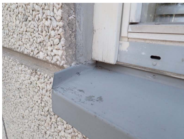
50. Reunassa on epätiiveyttä
