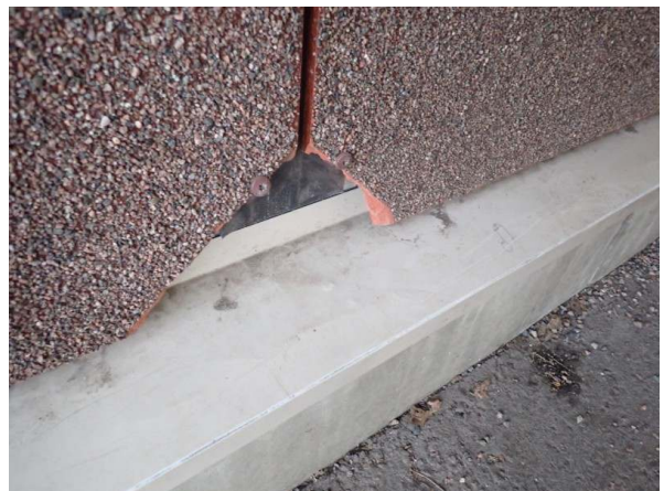
34. Ulkoseinän uusitusta levytyksestä on rikkoutunut kulmapaloja
