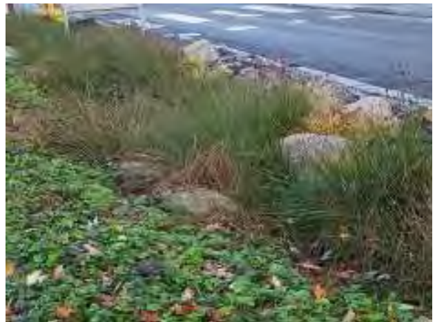
Katualueen viherkaistalle sijoitettu hulevesipainanne.
