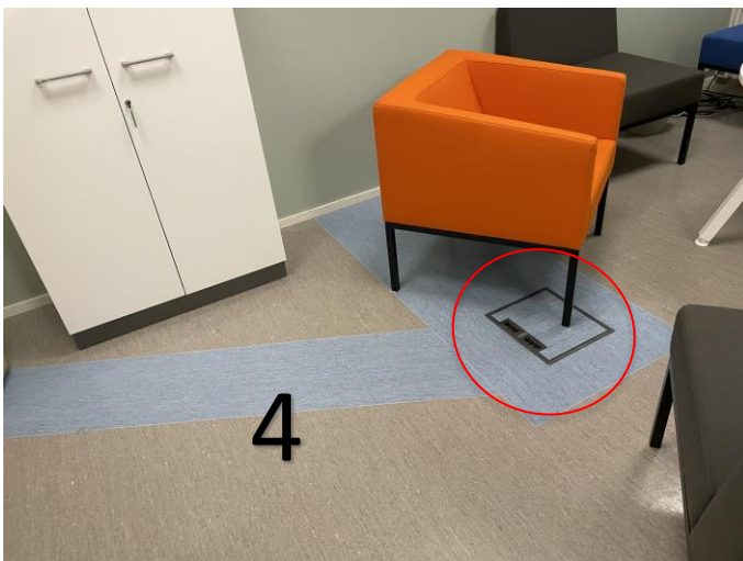
Havaintoja) Koiran havaintokohtia kokoushuoneessa lattian sähkökourun kohdalla. Hajut leviävät herkästi kourujen kautta.
