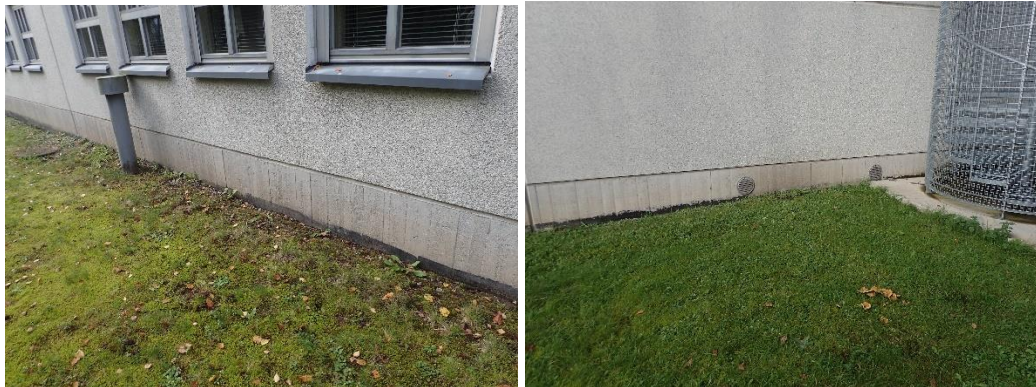
Kuvat 17 ja 18. Tilan 130 ulkopuolella on yksi tuuletuspaalu. kanvat haaroittuvat seinärakenteessa. Arkiston 146 korvauilmaventtiilit ovat maan tasossa.
