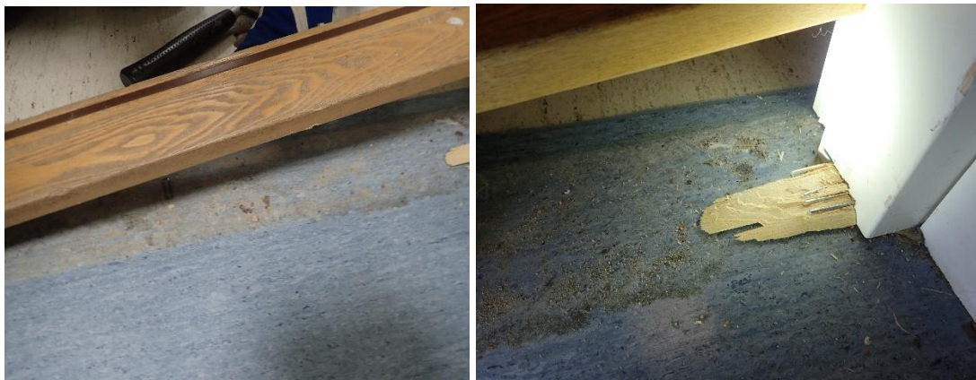
Kuvat 19 ja 20. Huoneen 240 käytäväoven kynnyksen alapuolen epäpuhtauksia.
