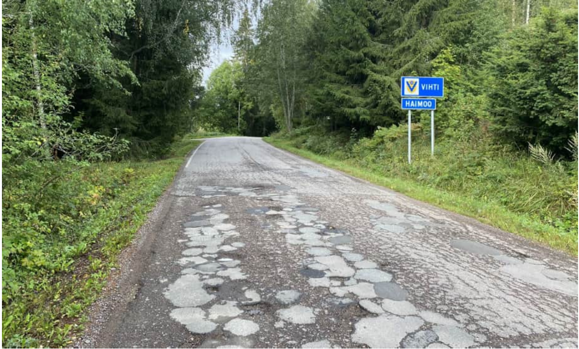
Kuva 2-26. Haimoontie on kapea, mutkainen tie, jonka pinnoite on erittäin huonossa kunnossa
