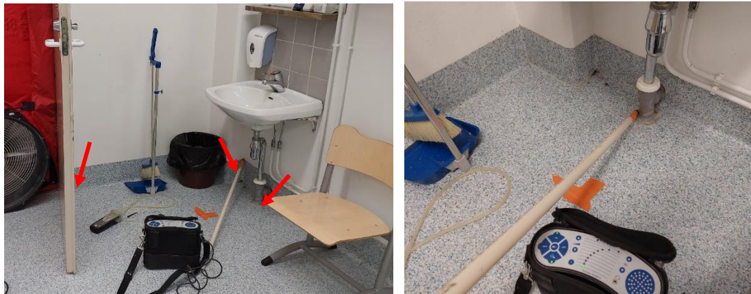
Kuvat 11 a ja b. Tila 122: heikkoa pistemäistä ilmavuotoa havaittiin lattia ja väliseinän liittymästä, pilariliittymästä ja viemärin läpiviennin kohdalta.
