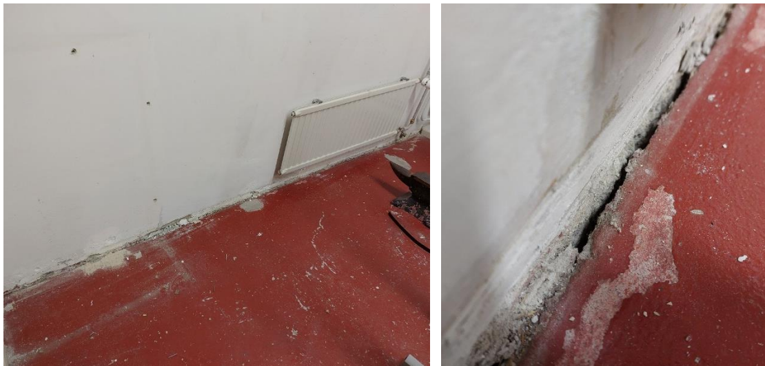
Kuvat 9 a ja b. Tilaan 136 tehty rakenneavaus RA5. Lattia-seinäliittymästä irrotettiin jalkalista, liittymässä oli selvä rako, joka oli ainakin 300 mm syvä. Liittymästä ei kuitenkaan havaittu poikkeavia hajuja tai selviä ilmavirtauksia.
