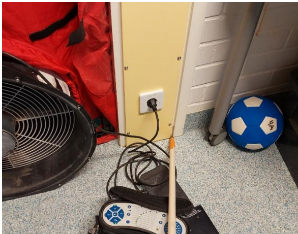
Kuva 14. Tila 162: Heikkoa pistemäistä ilmavuoto havaittiin lattian ja väliseinän liittymästä yhdestä kohtaa oven vierestä käytävän vastaiselta seinältä.
