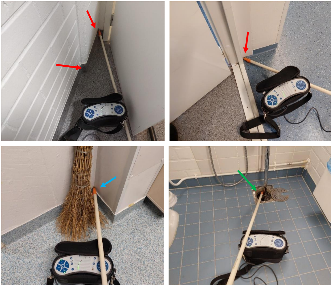
Kuvat 16 a...d. Putkikanaalin merkkiainekokeessa ilmavuotoa havaittiin käytävältä 164 kolmesta kohtaa (punaiset nuolet), tilasta 161 kotelon kohdalta (sininen nuoli) sekä WC-tiloista 178 ja 180 lattiakaivon kautta (vihreä nuoli). Kaikki havaitut ilmavuodot olivat heikkoja.
