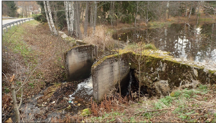
Alueen pohjoisreunalla, Tyrynojan uomassa on vanha betonipato. Peruskarttoja vanhemmilla kartoilla ojassa ei ole patoa eikä myllyjä. Kaakkoon.
